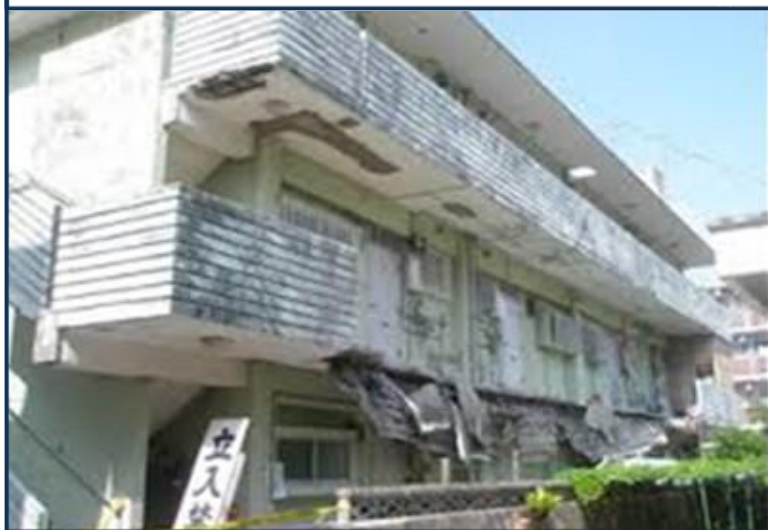
A市のマンション 外廊下落下部分
