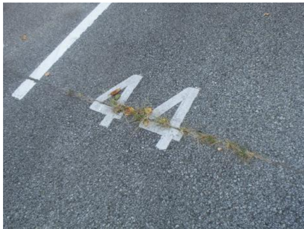
築40年の劣化状況（補修していない箇所）
