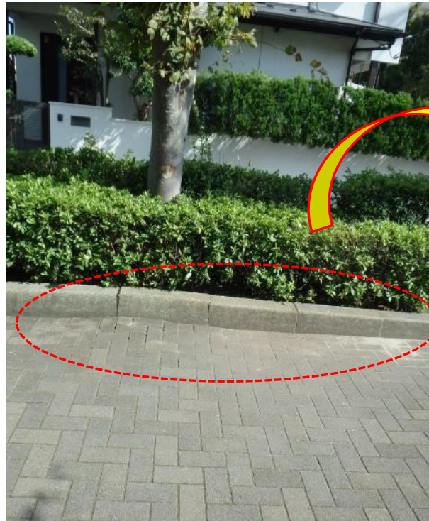
根が育ち舗装が隆起している
