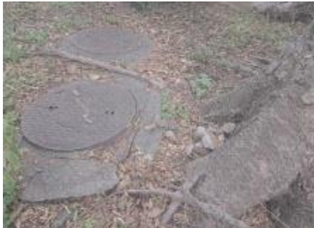
樹木により傾斜した排水柵
