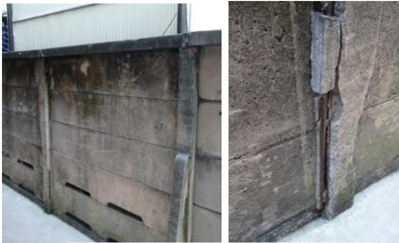
コンクリートパネル・支柱式の塀の劣化
