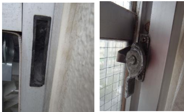
クレセント・引手の劣化
