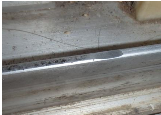
レールの凹みや傷 ガタツキの原因
