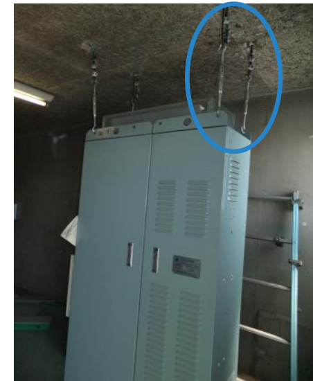
制御盤の転倒・移動防止
