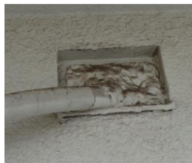
塞いで配管している例
