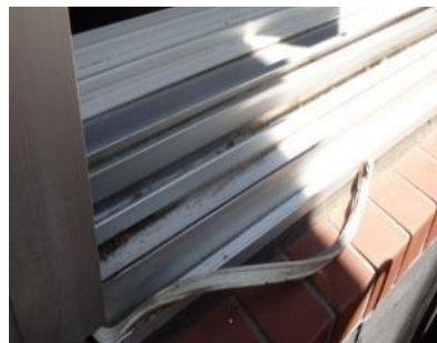
樹脂部品の脱落
