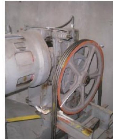
主索外止めの ない巻上機 (未改修)
