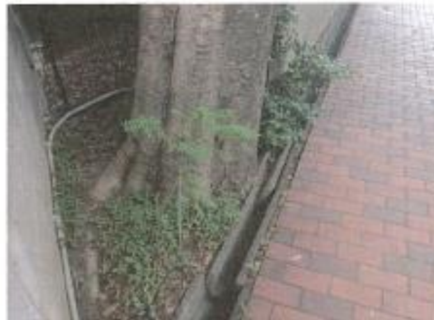
樹木により破損した雨水側溝
