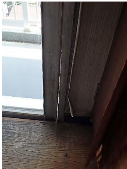
障子に歪みが出て隙間あり 風雨が入り込む
