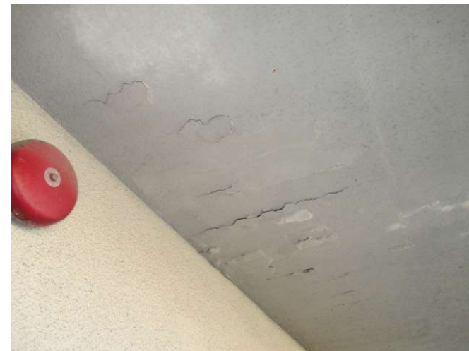
漏水による膨れ？
