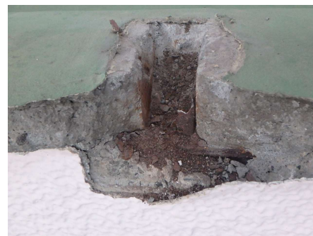
埋込部ベースプレート腐食
