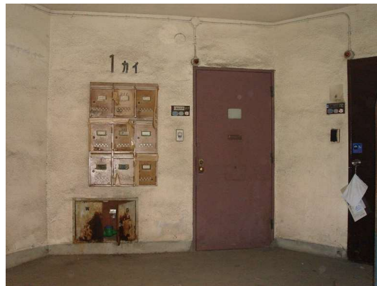
新築時のまま手入れがされていない玄関まわり
