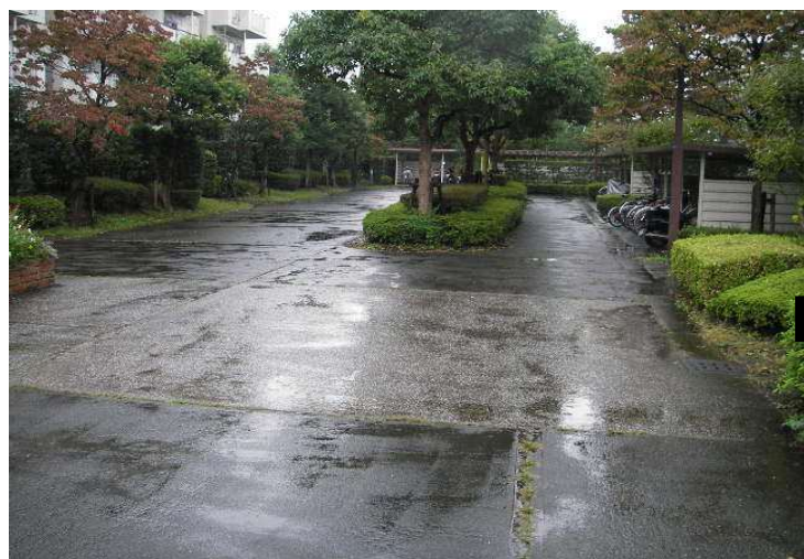
改修前のコンクリート舗装
