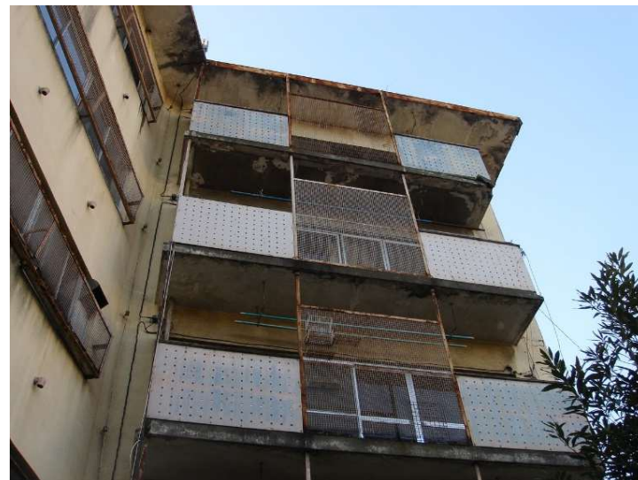
バルコニー天井・大庇の劣化が著しい
