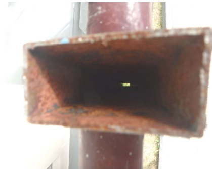
支柱内部の腐食
